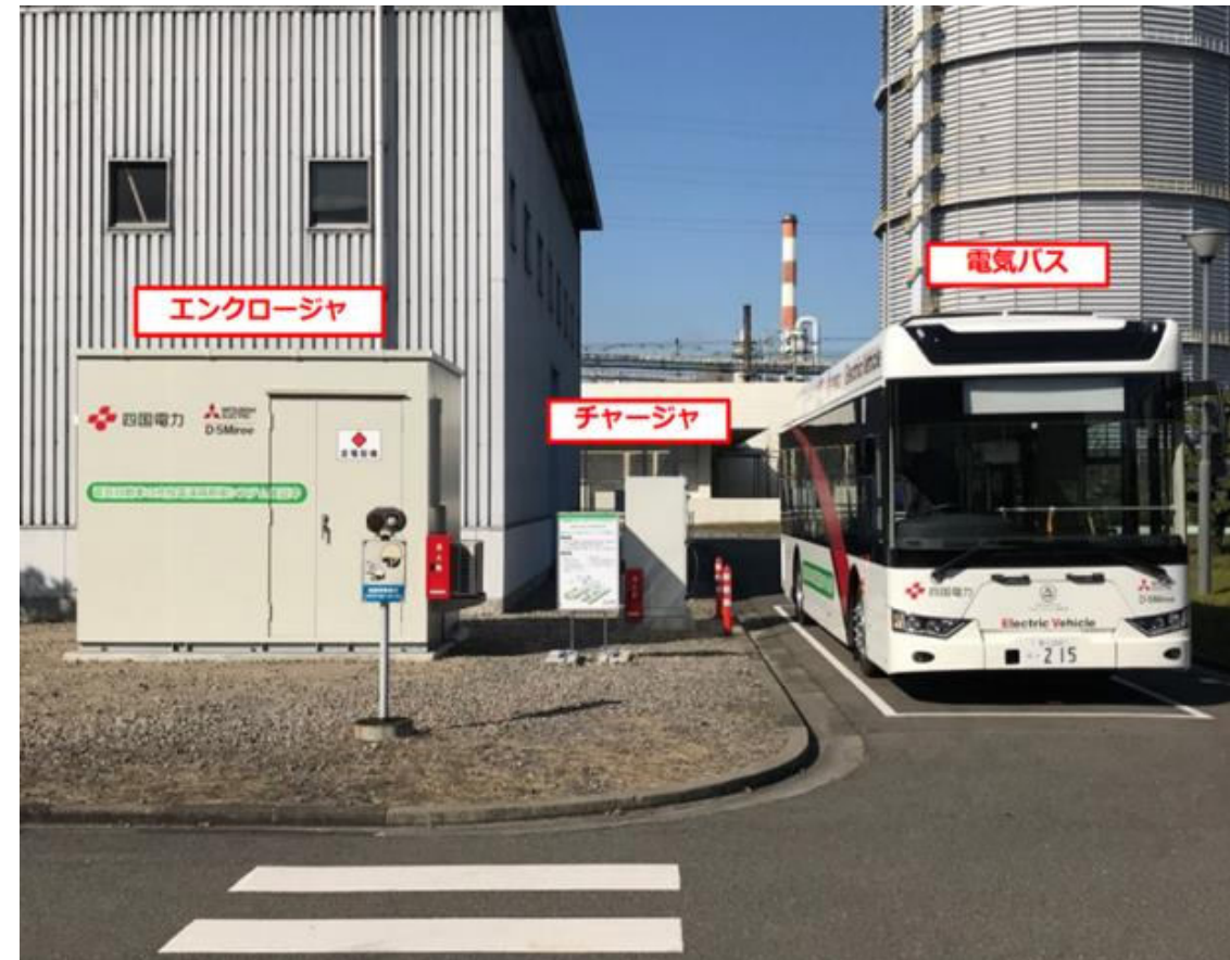
四国電力様 坂出発電所
